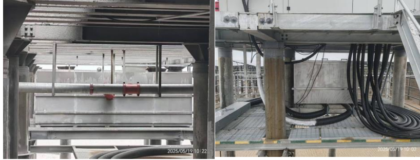
升压站事故油池
