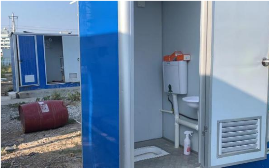
图 5.1-1 项目部生活区移动生态厕所
